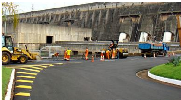
Figura 13 – Usina de Itaipu
